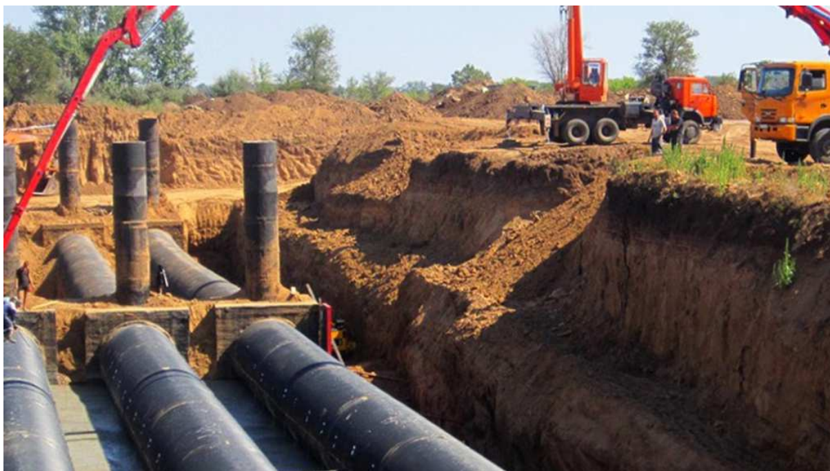
Рис. 2. Разрушение рельефа при прокладке подземных коммуникаций
